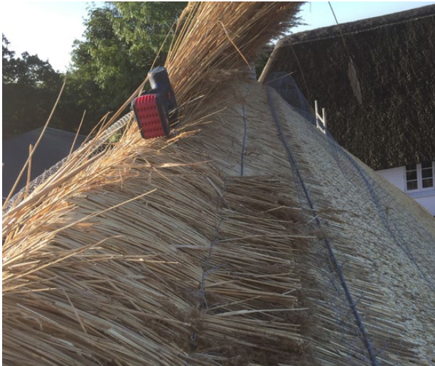
Foto 32 Rygning med overbuk
