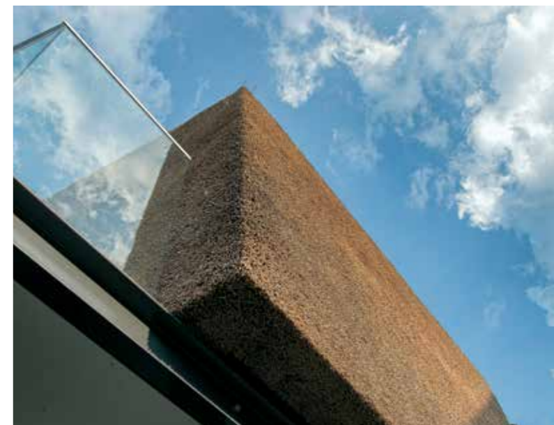
På bagsiden af huset ovenfor ses denne balkon. Rækværket af glas støder direkte op mod den tækkede flade.
