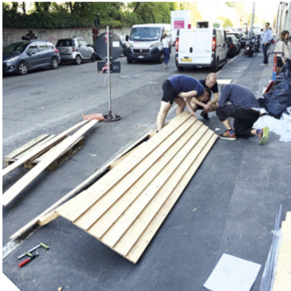
Tagrygningen af klinkbrædder samles udenfor i den sydlandske sol, så den senere kan fastgøres til saksespærrets forlængede tænger
