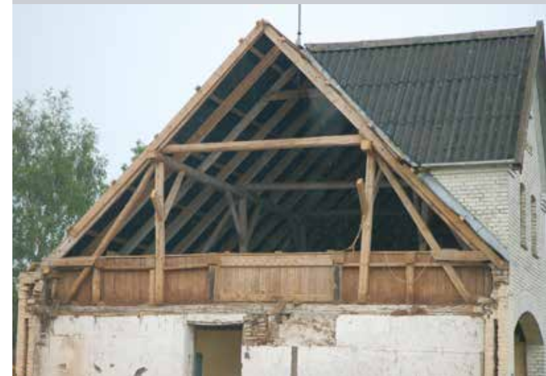
Under nedbrydning. Knastørt tagværk. Sønderjylland.
