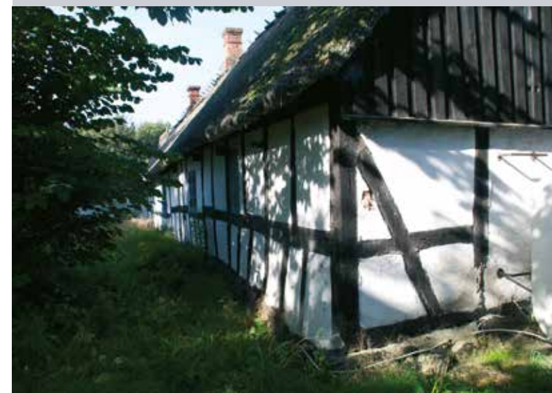
Stuehus, østjysk gård ca. 1775. Tømmer strøget med damptæt asfaltbitumen. Tavler reparerede og pudse med hård cementmørtel. Fugt og råd i facader under løsholterne.
