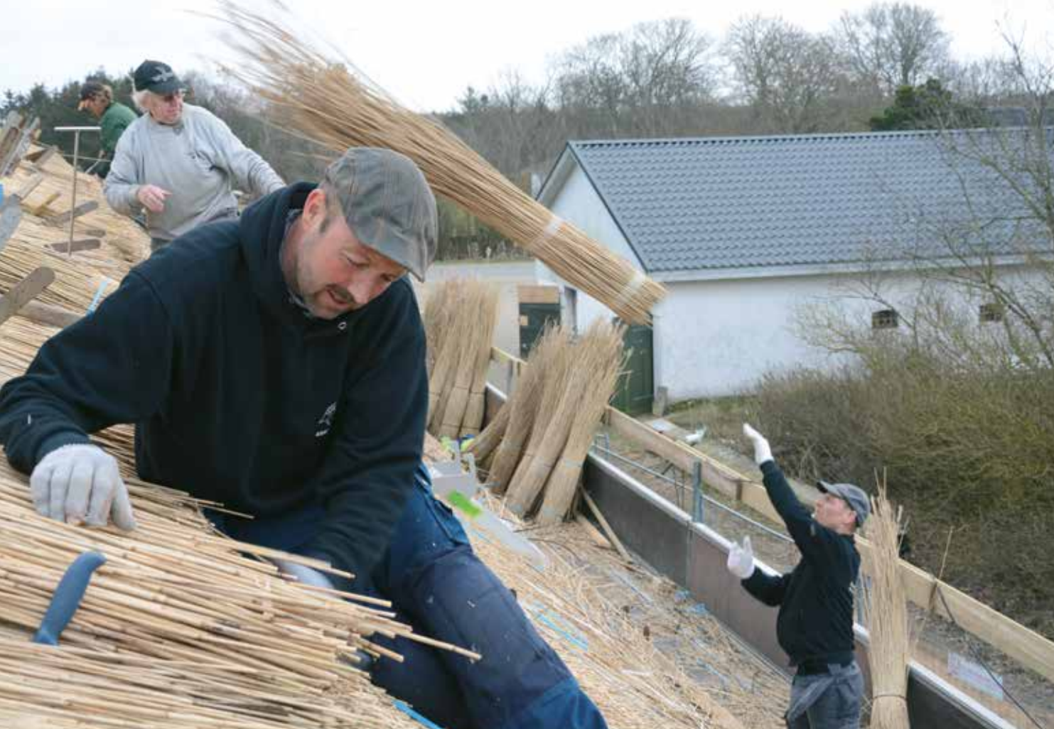
Hvis alt går vel er tækningen færdig i august. Vadehavscentret forventes at holde åbningsreception i slutningen af september.
