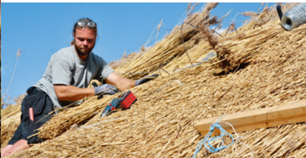
Her er tækkemand Daniel Obermüller, i gang med et tag. Daniel har købt Uggelhuse Tækkerør og blev dermed landets yngste rørhøster.
