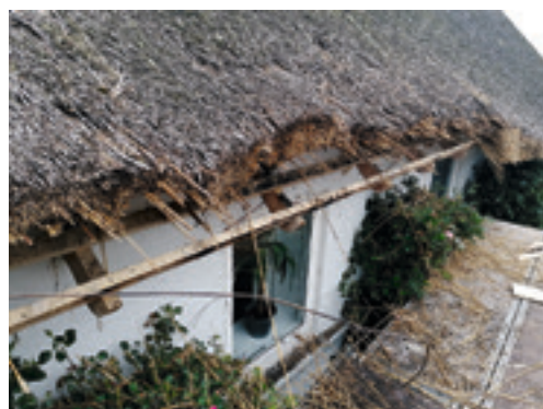
Foto efter omtækning af det skadede stykke stråtag. Heldigvis fik ilden ikke rigtig fat, og brandvæsenet var hurtigt fremme.
